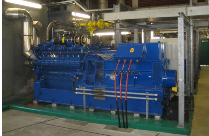
BHKW-Anlage im Bestand
